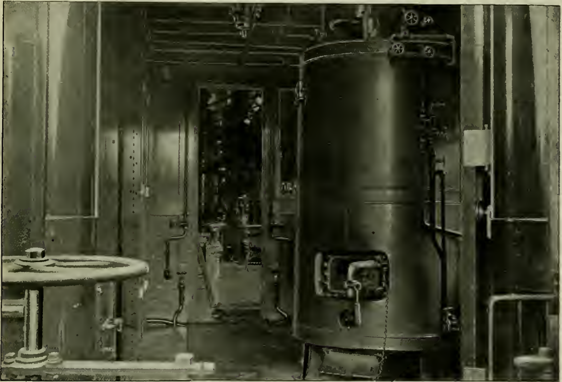
BOILER ROOM OF THE N. Y., N. H. & H., NEW AIR BRAKE INSTRUCTION CAR.
